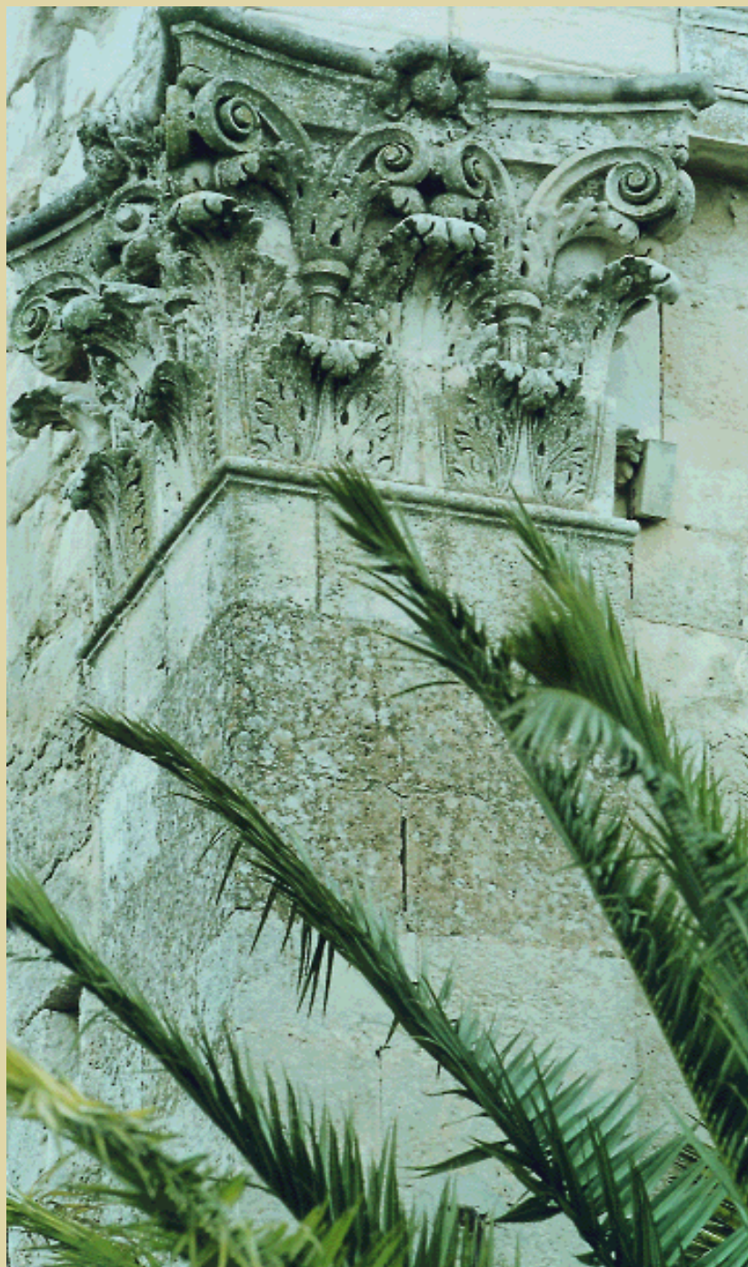
Chiesa di S. Sebastiano particolare di una lesena del prospetto
