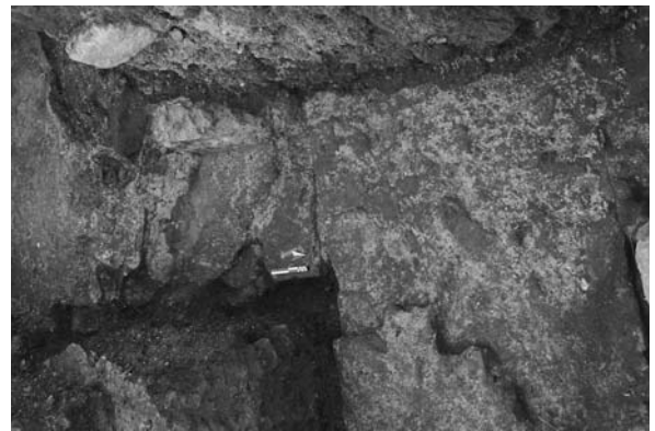
Fig. 15. Il muro perimetrale nord della basilica rinvenuto nel 2009. In evidenza la fondazione perpendicolare in blocchi di rosso di Verona, legata al muro perimetrale.
