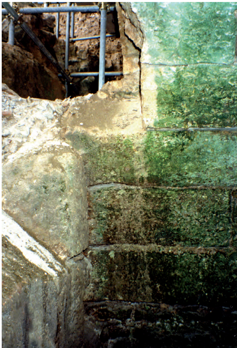
Fig. 29 - Parte terminale della cloaca orientale verso l'esterno; si nota la risega dell'ispessimento del muro in cui si apre la parte inferiore della sua volta
