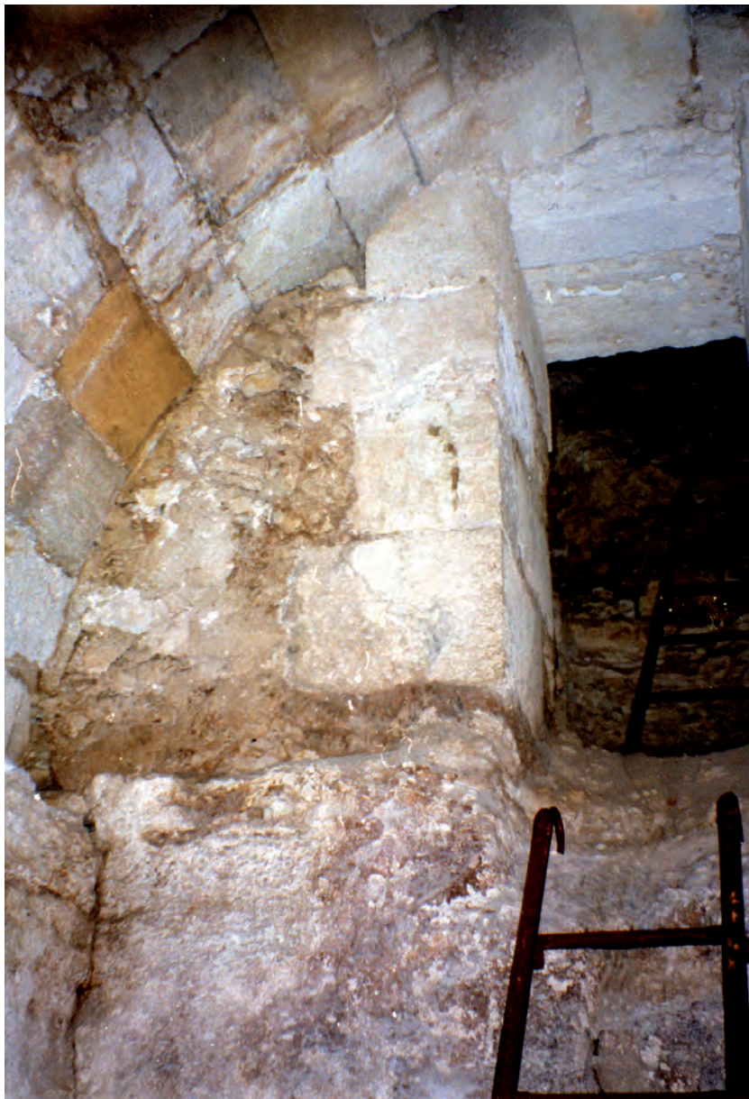
Fig. 46 - La cloaca sotto la garderobe settentrionale: la volta di copertura (sottostante al muro perimetrale del Castello) con il tomagno di contenimento del terrapieno per il calpestio all'interno della sala ipostila. In basso si vede che il vano era stato ricavato scavando nella roccia
