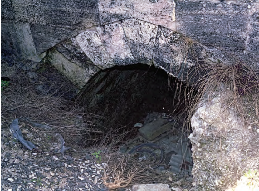
Fig. 26 - L'archivolto che segna all'esterno l'apertura della cloaca ad Est, obliata tra la fine del Cinquecento e gli inizi del Seicento, quando venne realizzato il grande terrapieno a difesa della parte basamentale del Castello
