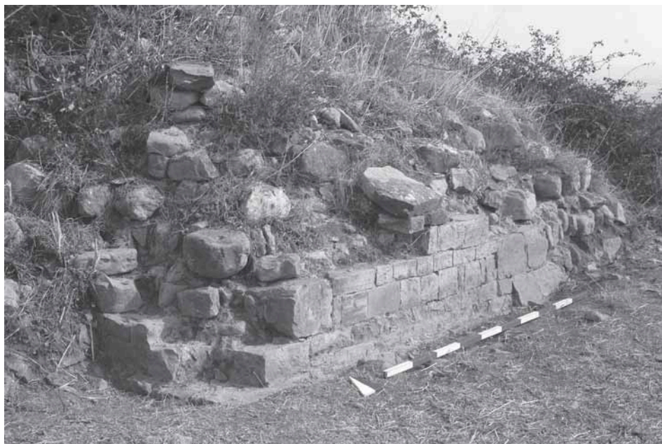
Fig. 11 - Particolare della robusta struttura con profilo a scarpa, ubicata in corrispondenza della facciata della chiesa.
