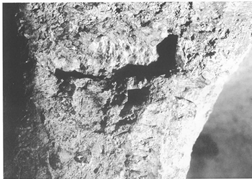
Fig. 7 - Siracusa, catacomba di S. Giovanni, rotonda di Adelfia: arcosolio anonimo, particolare dell'impronta e del foro di fissaggio del capitello a sinistra; al di sopra, incasso per mensola.
