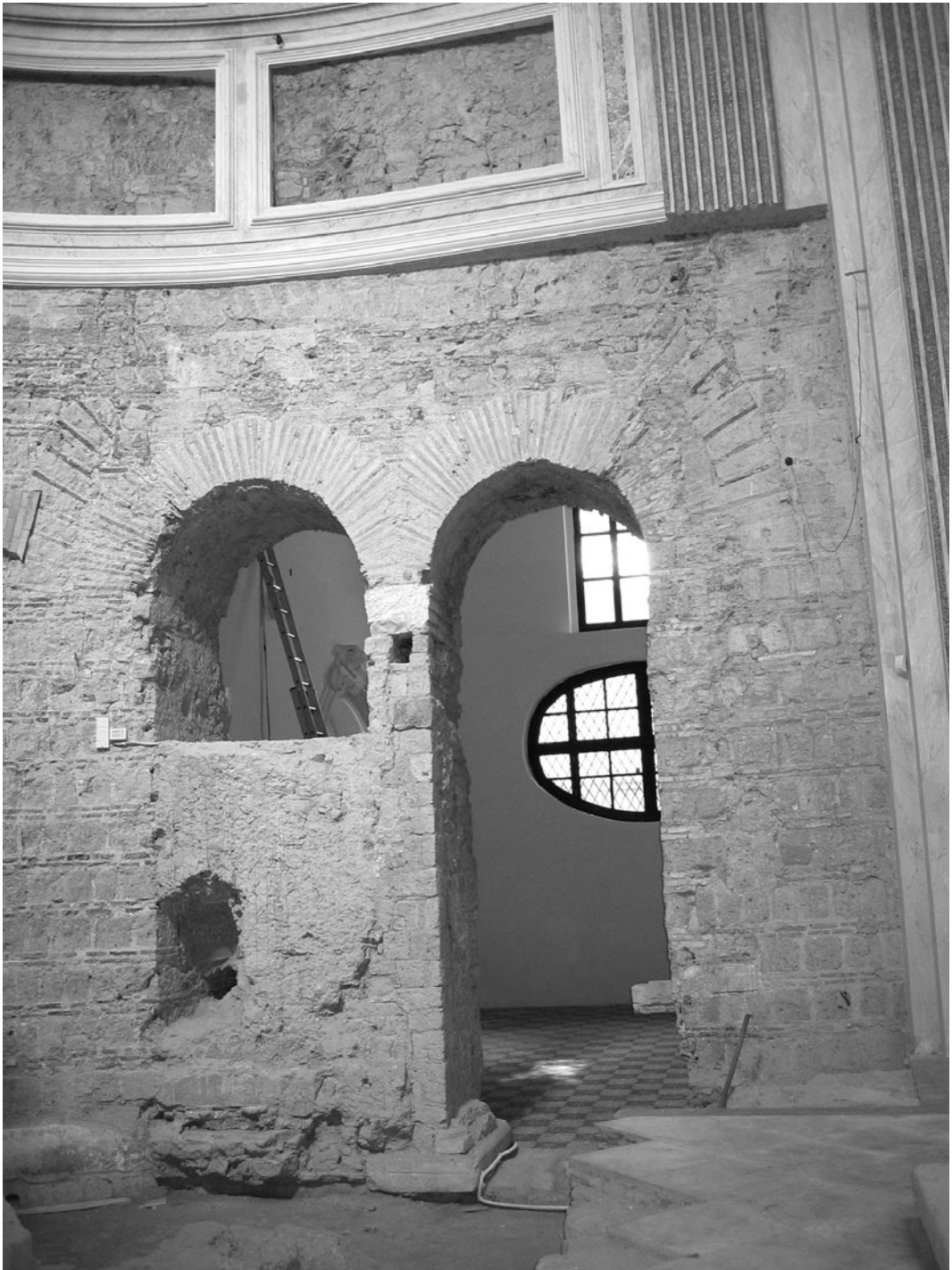
Fig. 32. Presbiterio della chiesa di San Giovanni Maggiore, bifora destra prima dei lavori del 2006-09 (fotografia C. Ebanista).
