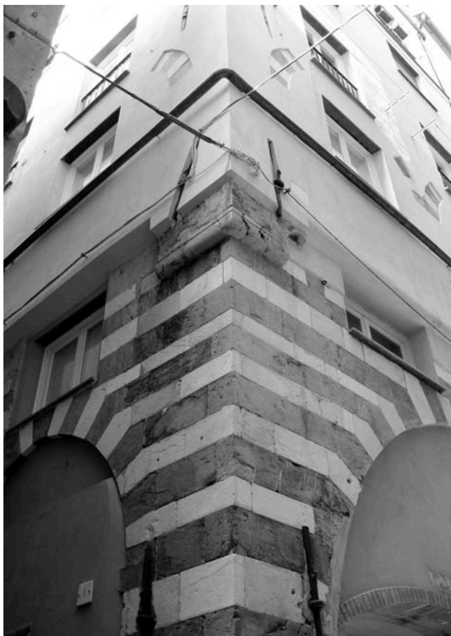
Fig. 5. Genova, Angolo del palazzo tra vico Indoratori e vico di Scurreria la Vecchia. In alto si vedono gli archi delle trifore (Foto P.F. Tomarchio)
